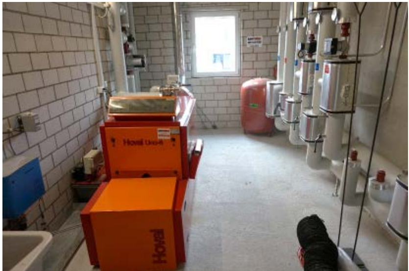
Bildlegende: Die Ölheizung der Marke «Hoval Uno-3 b-i» mit einer Leistung von 95 kW, erreicht einen Wirkungsgrad von bis zu 98%. (Quelle: Roppel AG)
